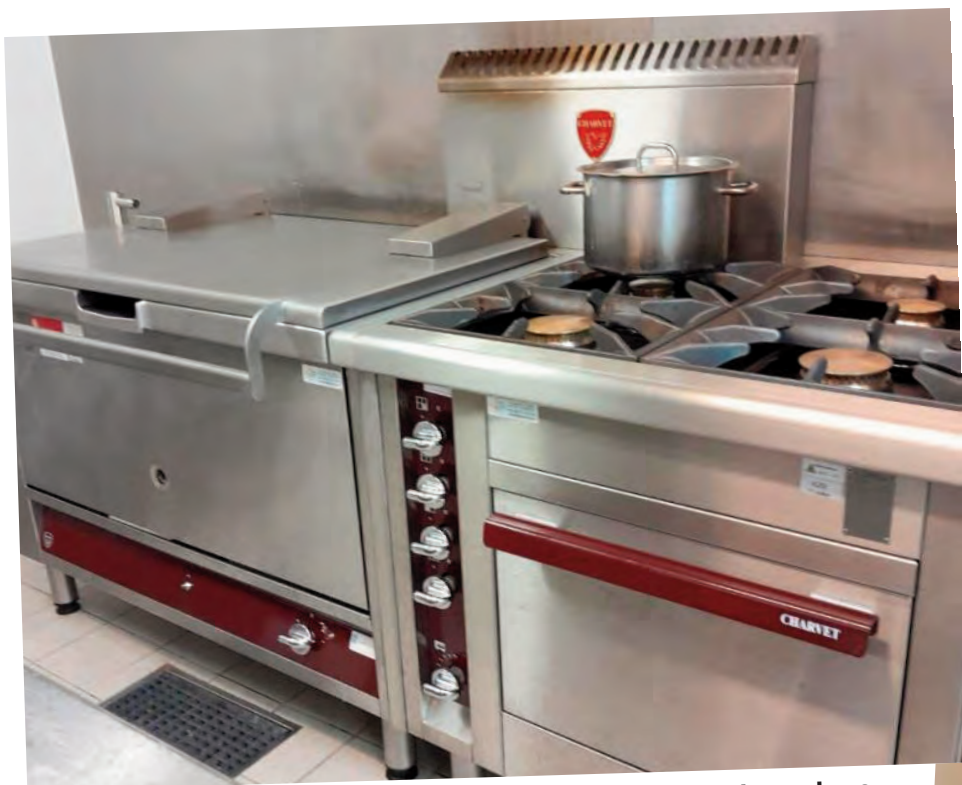
Afin de permettre au personnel du restaurant scolaire de travailler dans de bonnes conditions, le matériel de la cuisine a été renouvelé : acquisition d'une sauteuse, d'un piano et d'une fontaine à eau.
